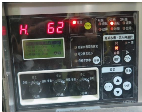
ポンプ電源切替器
