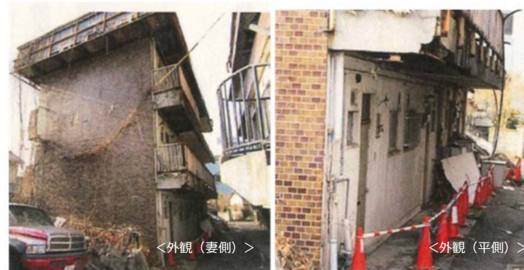
<行政が代執行により除却した事例>
