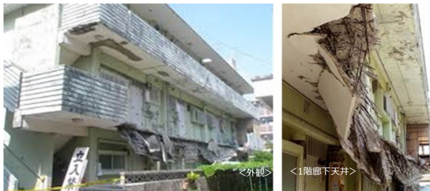
マンションの2階廊下部分が崩落した事例
