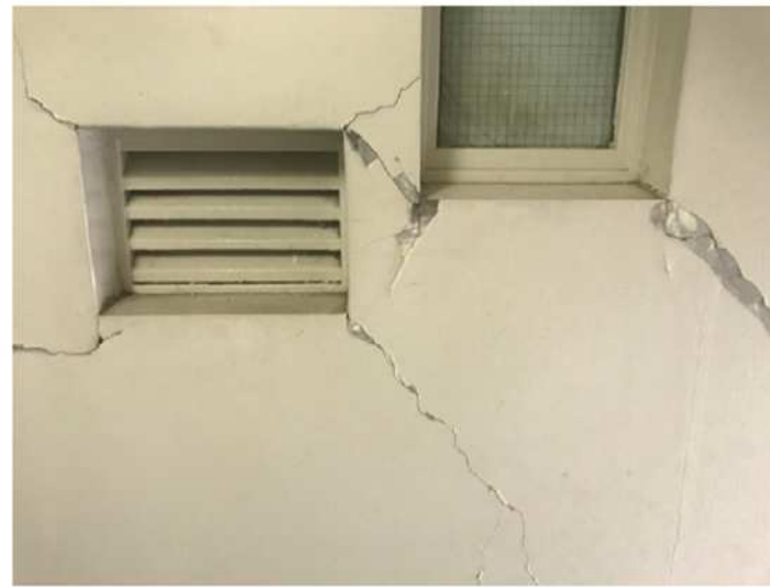
(外廊下の窓廻りクラック)
