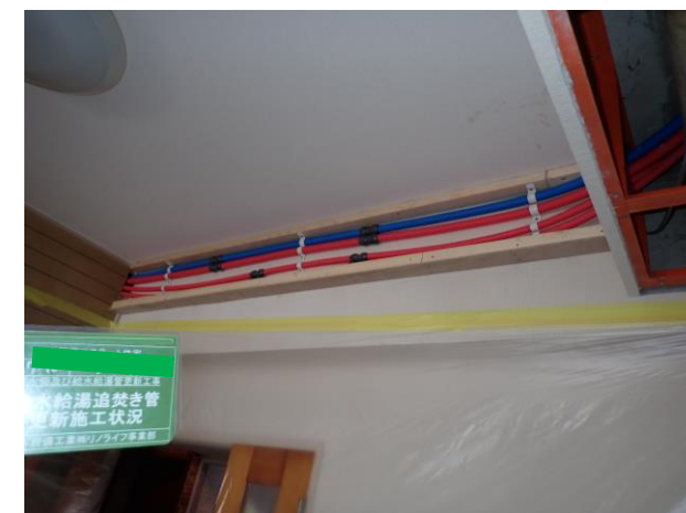
ダイニング天井配管
