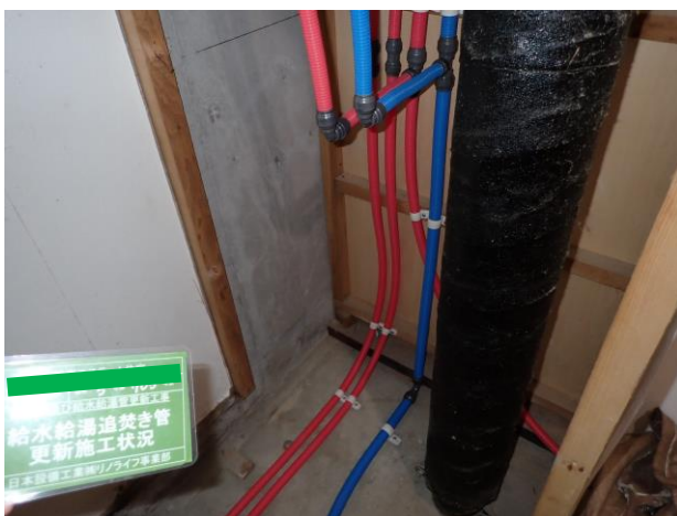
洗面室立下り配管
