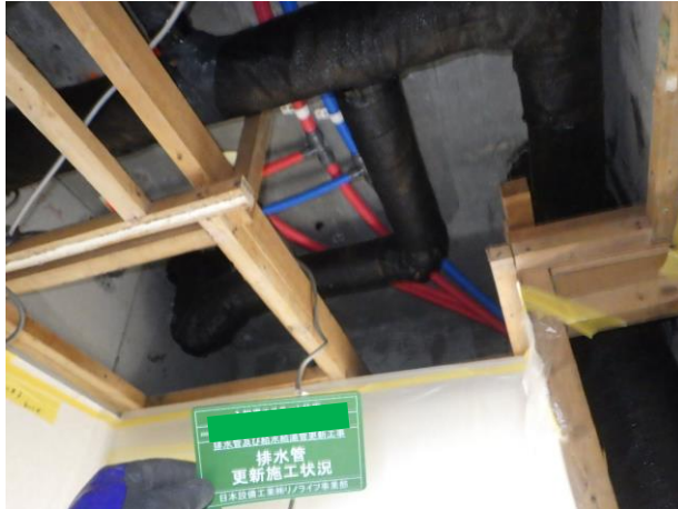
既存下階天井配管
