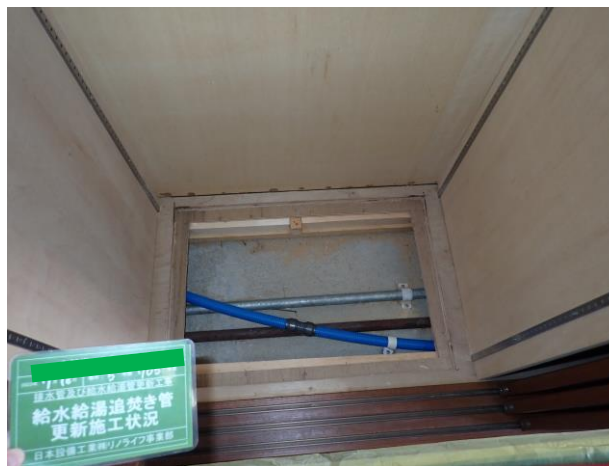
物入れ内給水配管
