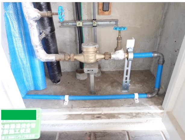
パイプスペース内
