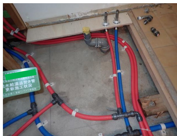
洗面室床下配管
