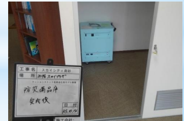
非常用蓄電池
