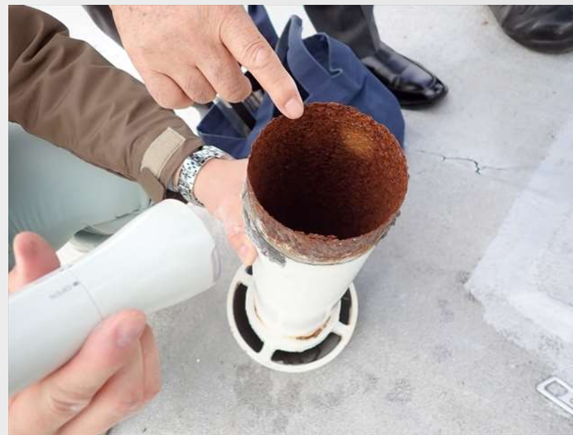
屋上伸頂通気ベントキャップ部の劣化状況
