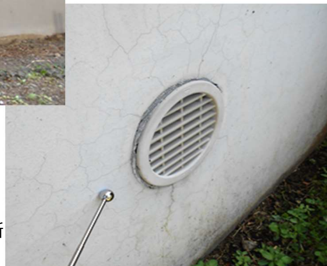
通気口周りのシーリング破断 およびモルタルにクラック有り
