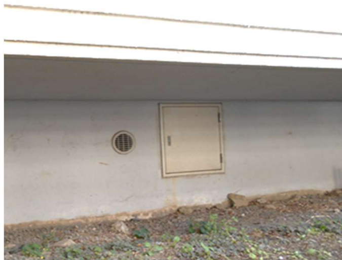
クラックおよび点検口 下部の発錆
