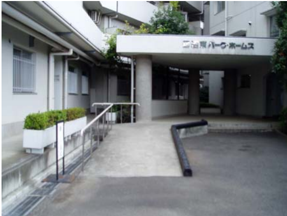
廊下と屋外路盤に段差のある改修前のエントランス廻り
